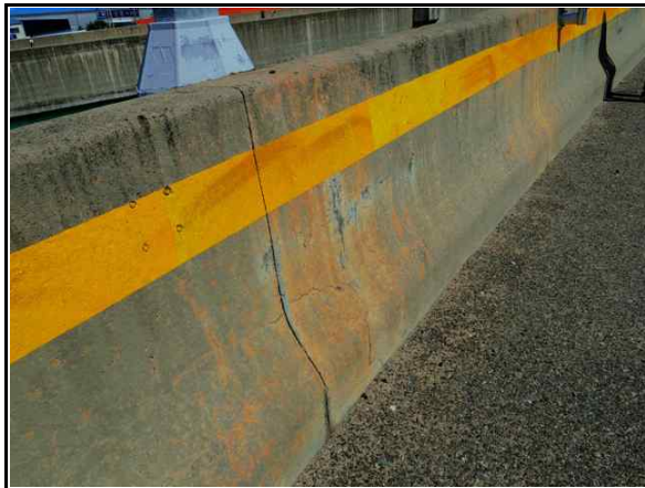
콘크리트 균열 (S1경간)
