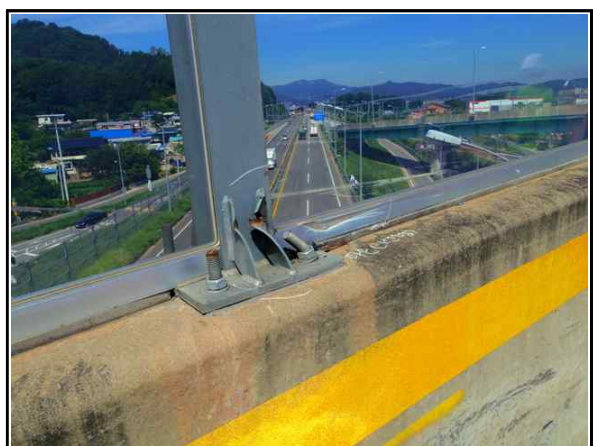
방음벽 지지대 파손 (S3경간)
