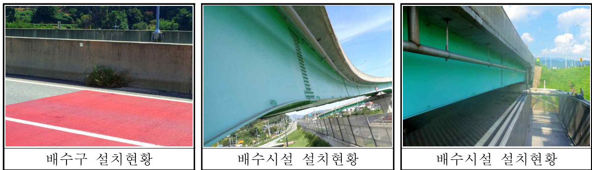
【그림 3.24】 배수시설 현황
