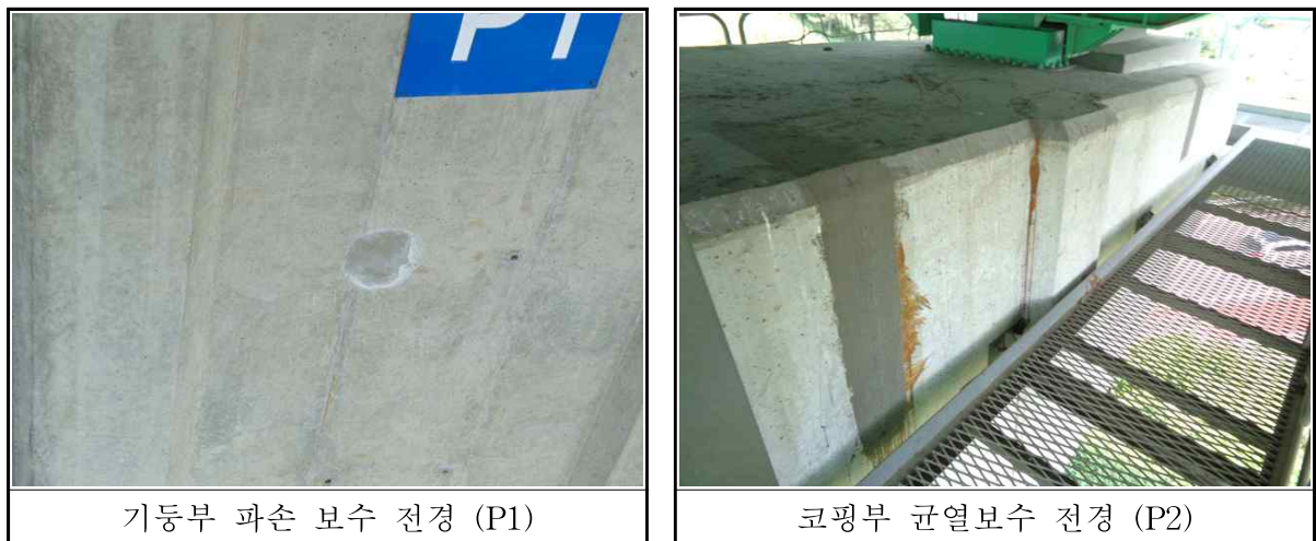
【그림 3.18】 교각 손상 현황
