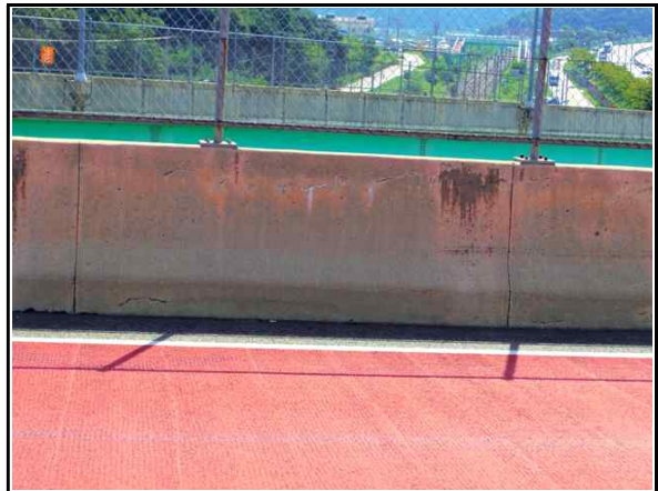
균열 및 백태 (S2경간)
