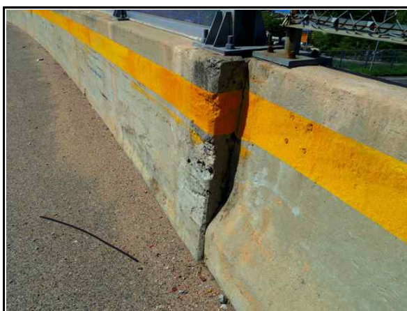
콘크리트 파손 (S2경간)
